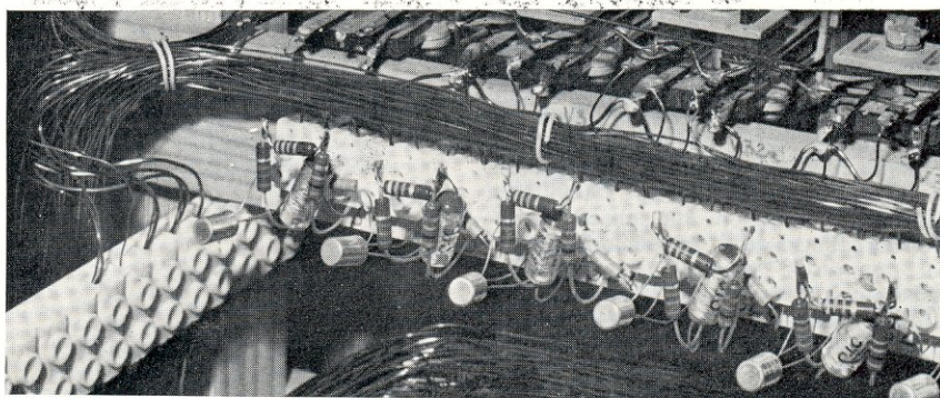
Une partie des cellules BATH qui assurent la sécurité sur le réseau de l'auteur.
